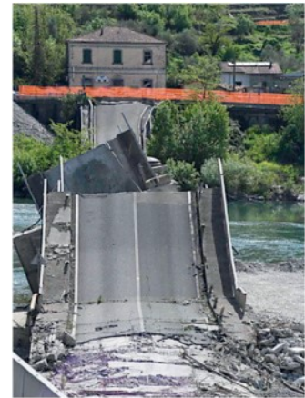
Il ponte crollato
